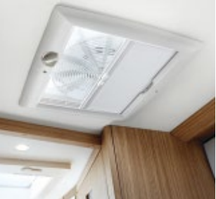
V3009011 Ventilator boven keuken
